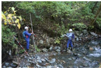
岩手県久慈市内 田子内川 自然河岸崩壊箇所被災調査 （令和元年10月20日）
