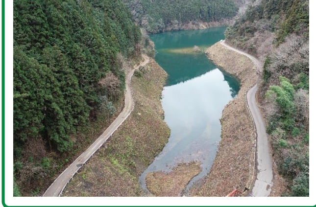
⑥R5新丸山ダム貯水池中流部伐採工事 (令和6年 3月完了予定)
