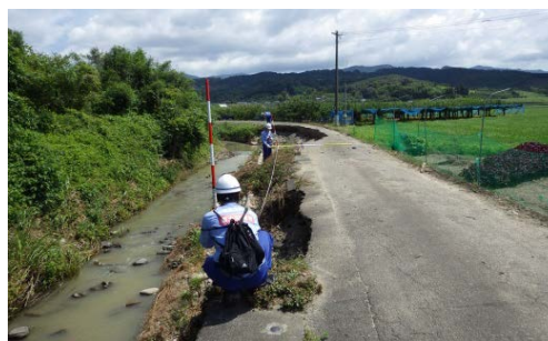
【被災状況調査(九州北部豪雨)】
