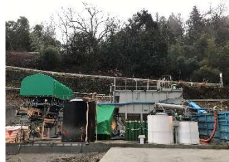
濁水プラント
