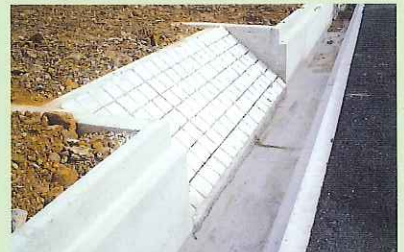
小動物が脱出できるようにスロープを設置した側溝
