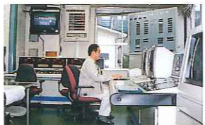
【操作室(そうさしつ)】でダムを監視します
