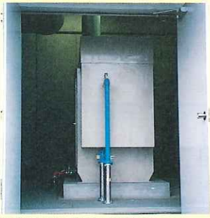
平成8年度に設置された発電機
