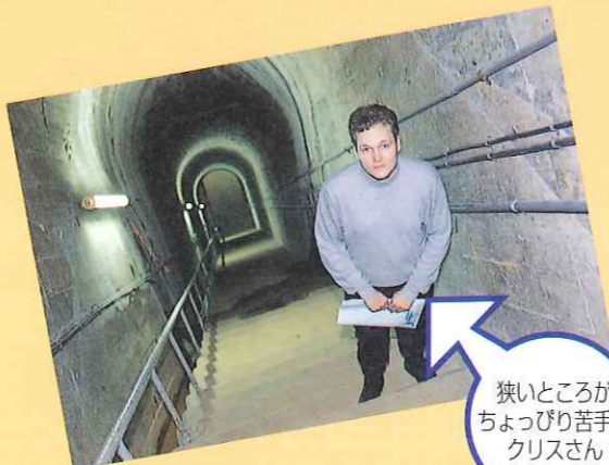
▲今回、初公開のダム内にある階段、 写真で見ると実際はもっと急でした。
