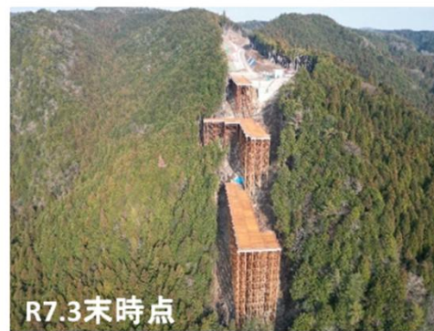
②令和6年度 新丸山ダム国道418号7号橋飯地下部工事 法面の一部が崩落したため、復旧対応を行っています。
