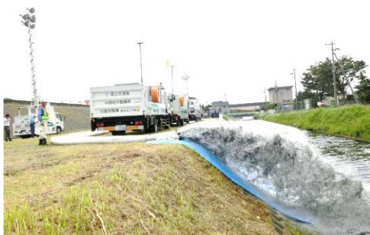
濃尾平野排水オペレーション (松陰東排水機場)
