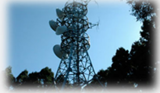
防災行政無線設備の被災
