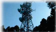
防災行政無線設備の被災
