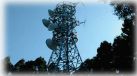
防災行政無線設備の被災
