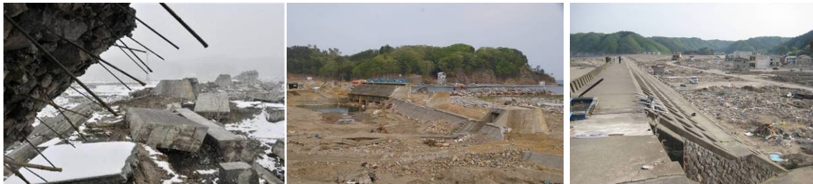
◇津波で損壊、越流した田老防潮堤（岩手県宮古市）
