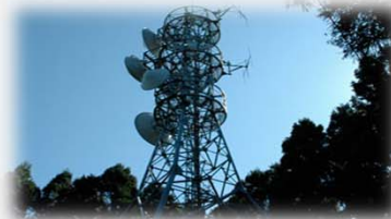
防災行政無線設備の被災
