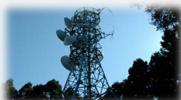
防災行政無線設備の被災
