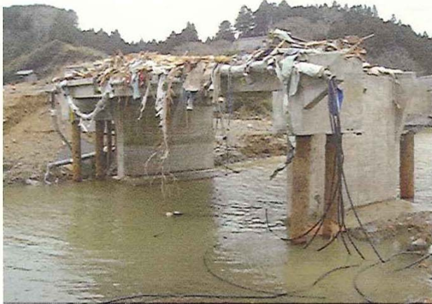
▲被災状況(橋台背面盛土流出)
