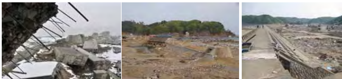
津波で損壊、越流した田老防潮堤（岩手県宮古市）
