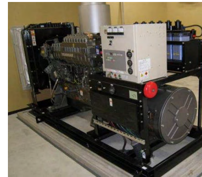
< 非常用発電設備 >
