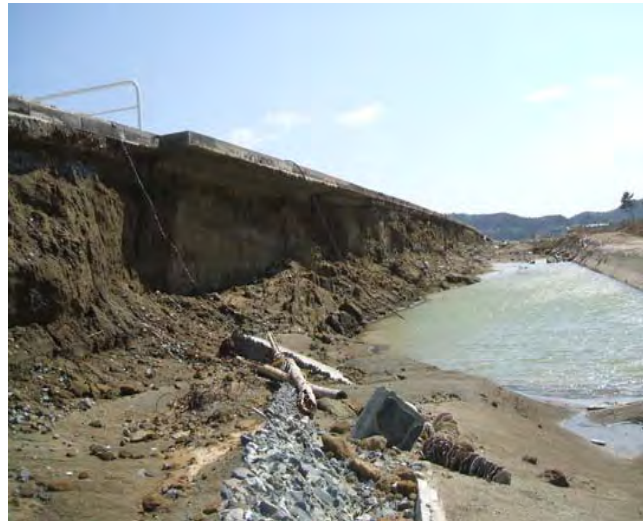
東日本大震災における海岸堤防の被災状況
