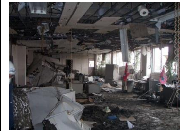
津波被害を受けた石巻出張所
