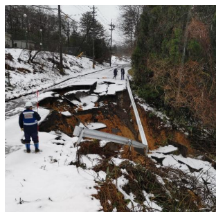
道路被害状況の調査
