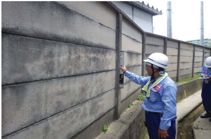
ブロック塀の応急危険度判定調査
