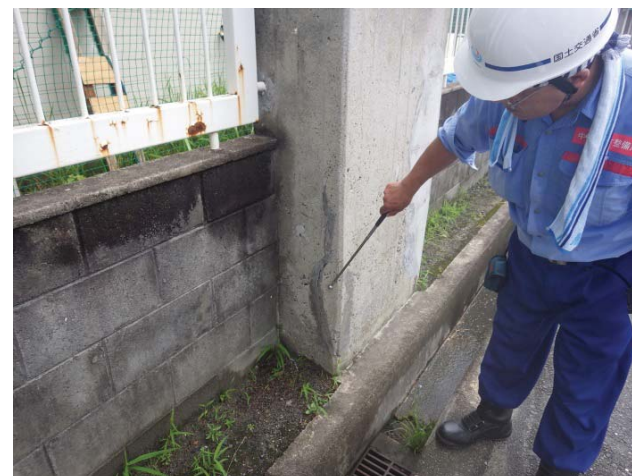
ブロック塀の応急危険度判定調査
