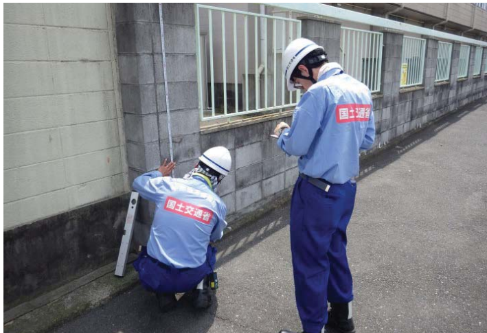
ブロック塀の応急危険度判定調査
