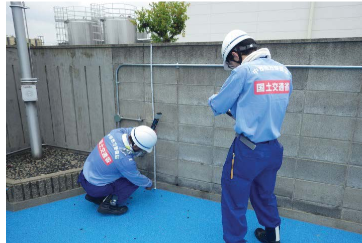
ブロック塀の応急危険度判定調査
