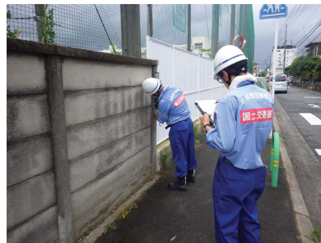
ブロック塀の応急危険度判定調査
