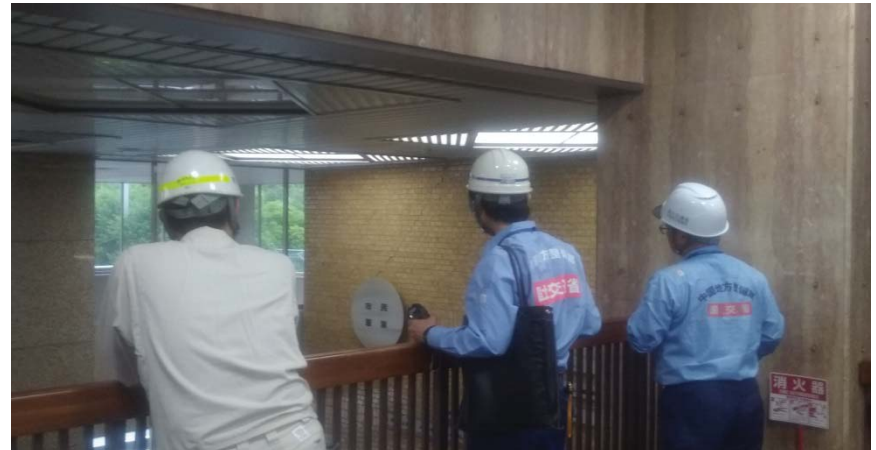
茨木市役所本館における被災状況調査
