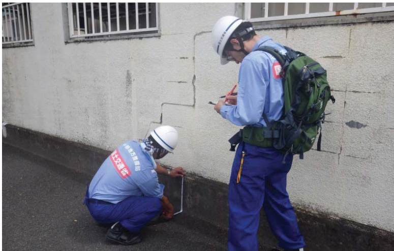
ブロック塀の応急危険度判定調査
