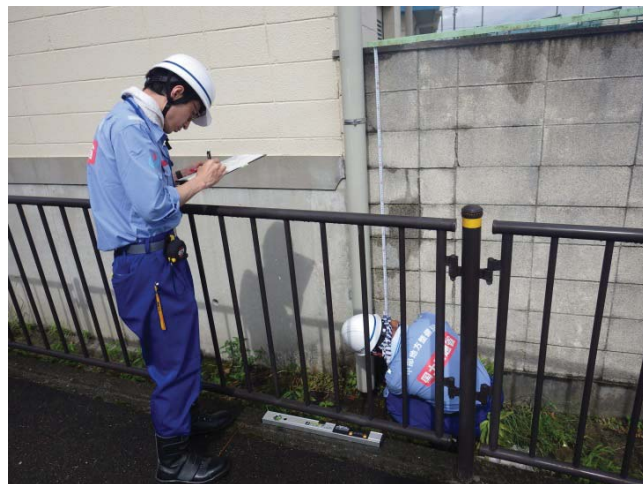
ブロック塀の応急危険度判定調査
