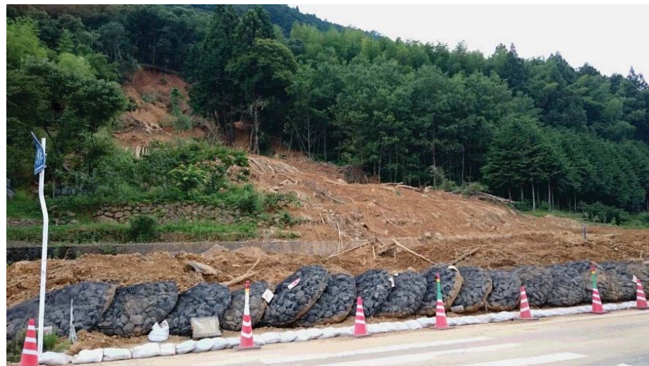
土砂崩落箇所（国道197号）
