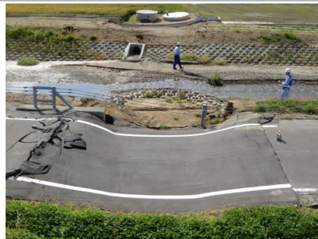
厚真町の道路損傷(ドローンによる撮影)
