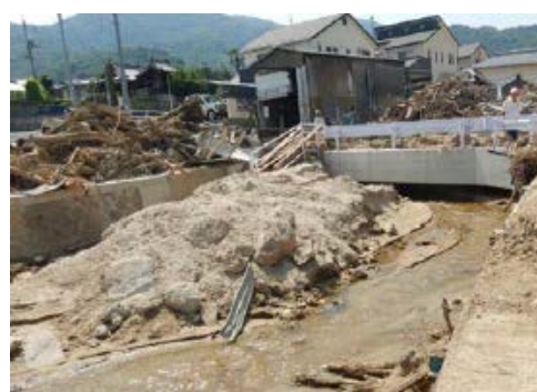
土石災害による土砂堆積の状況（広島県安芸郡坂町）
