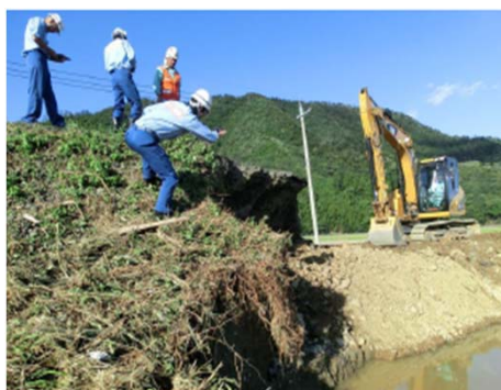
【野木川破堤箇所調査(河川班)】
