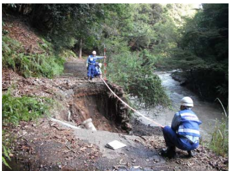
【主要地方道被災状況調査(道路班)】
