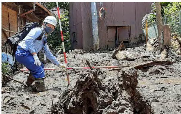
被災箇所の調査
