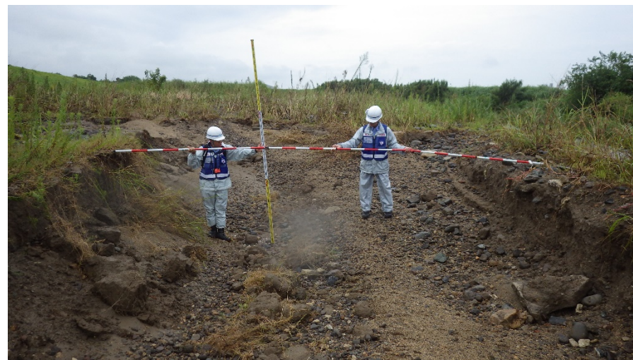
巨瀬川における被災状況調査(河川調査2班)
