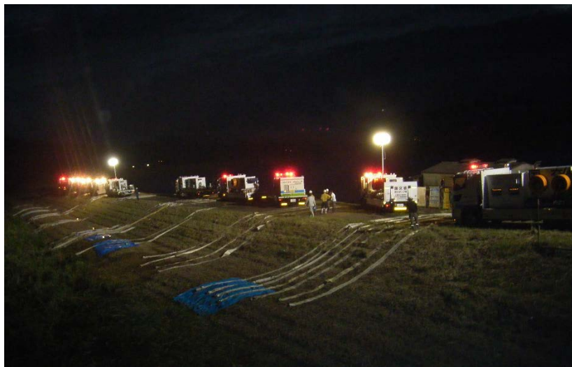
六角川(佐賀県大町町)での排水作業
