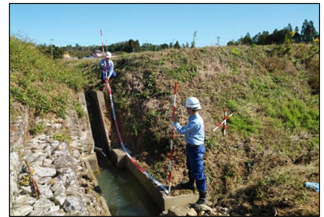
西高松川(福島県南相馬市)被災状況調査 (砂防調査班)
