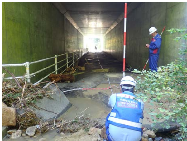
福島県南相馬市 市道西130号線 道路被災状況調査（道路調査班）
