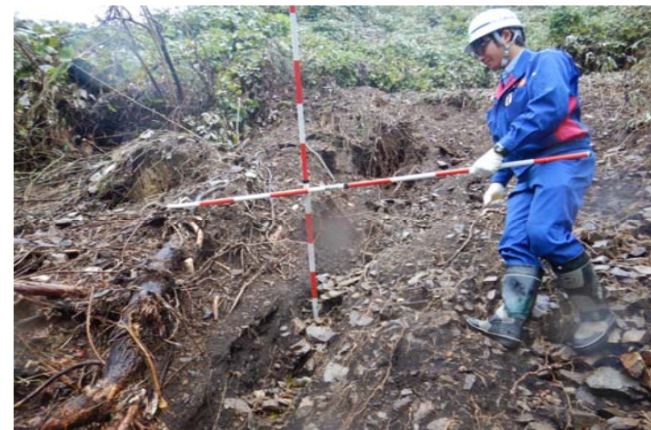
岩手県宮古市 急傾斜地の被災状況調査
