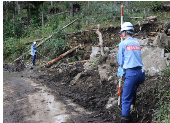
岩手県釜石市鎌倉峠付近 被害状況調査
