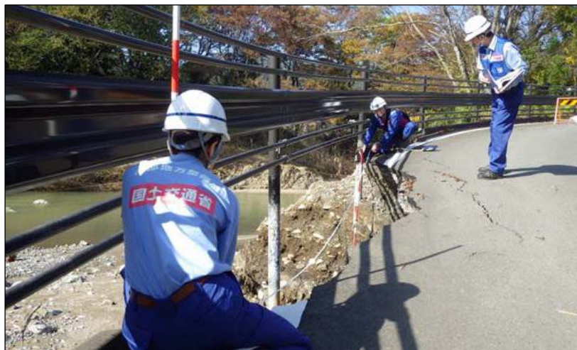
福島県相馬市上山柳下 宇田川被災状況調査（河川調査班）
