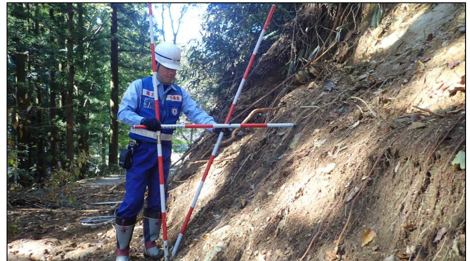
市道高倉線(福島県南相馬市)被災状況調査(道路調査班)
