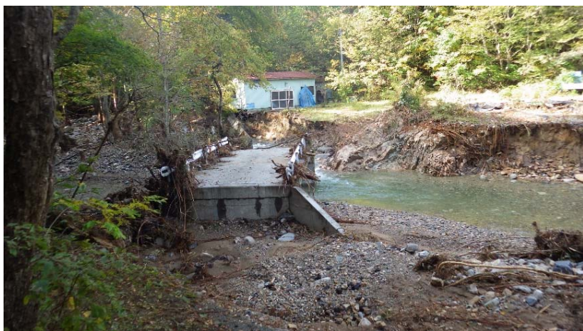
岩手県宮古市 市道御平線被災調査
