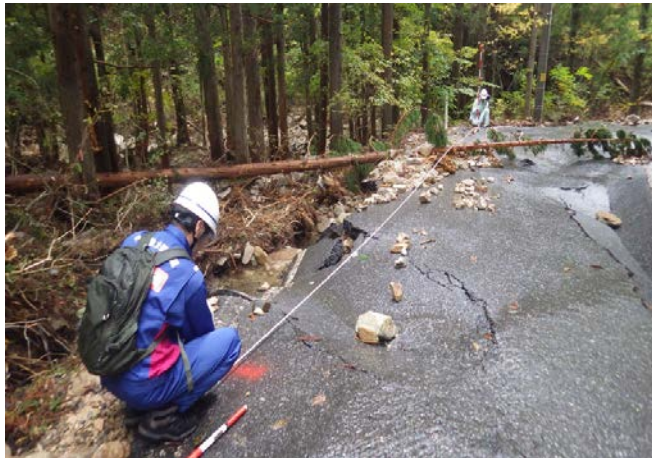
岩手県宮古市 市道熊の平堀内線 被災状況調査
