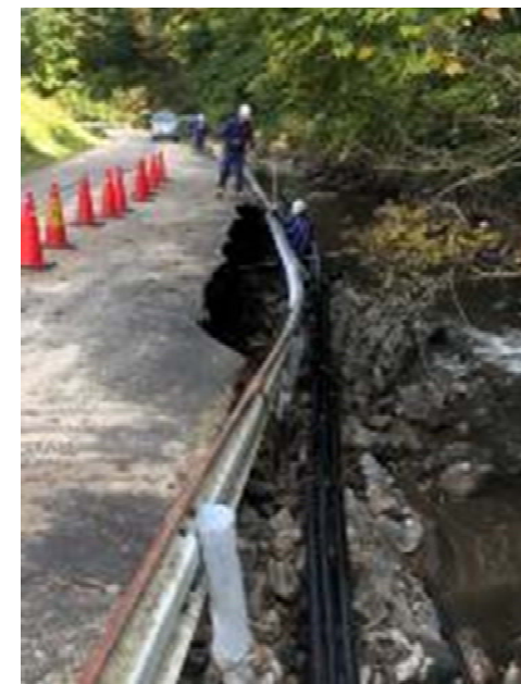
岩手県普代村 沢港線被災調査
