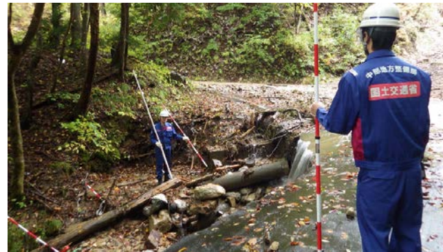
岩手県宮古市 市道熊の平堀内線 被災状況調査
