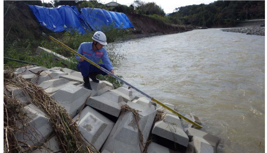
福島県相馬市 被災状況調査
