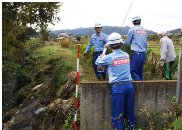
川原田川(福島県南相馬市)被災状況調査 (河川調査班)
