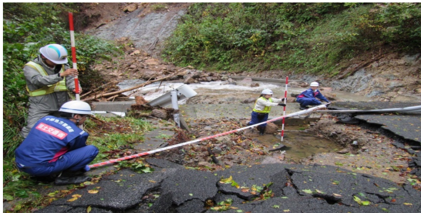
岩手県宮古市 市道宿浜1号線 被災状況調査 (道路調査班)
