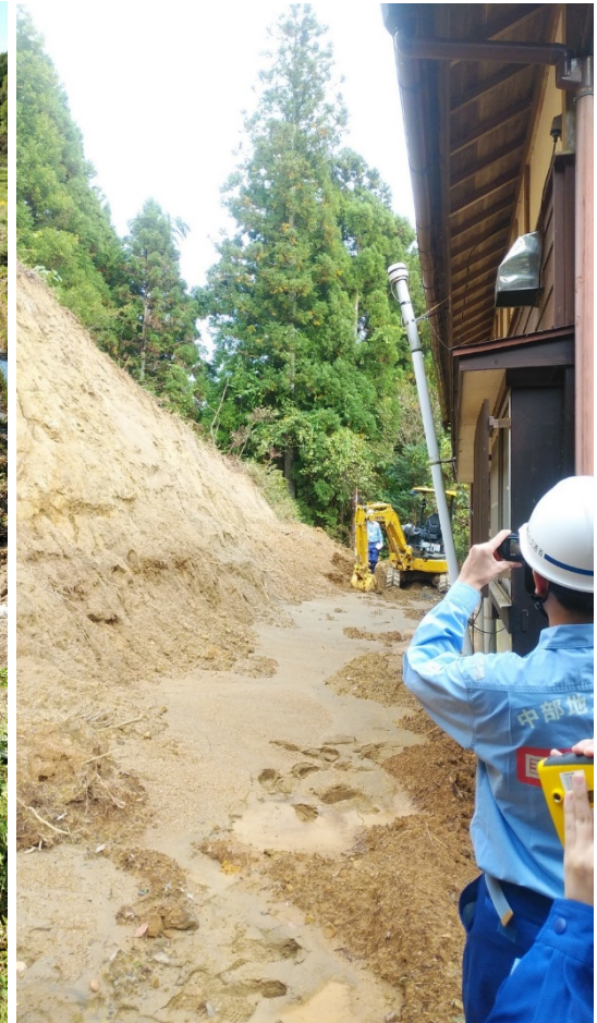
福島県いわき市 被害状況調査 (砂防調査班)
