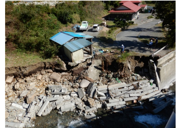
岩手県宮古市川代地区 被災状況調査
