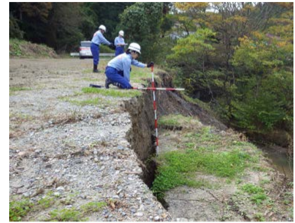
瀬ノ沢川(福島県南相馬市)被災状況調査 (河川調査班)
