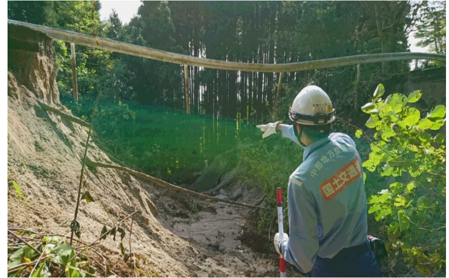
岩手県下閉伊郡山田町船越地内 被災状況調査
