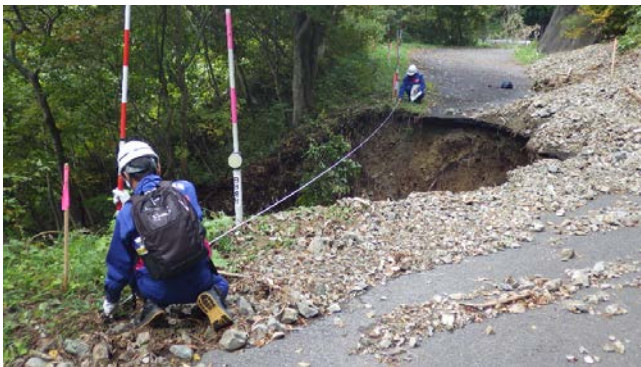
岩手県田野畑村 明戸北山線 被災状況調査
