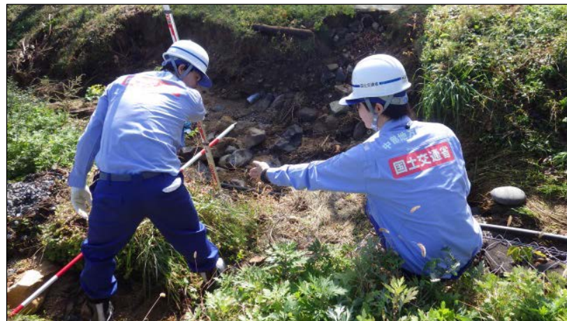
宮城県丸森町 松掛川被災状況調査（河川調査班）
