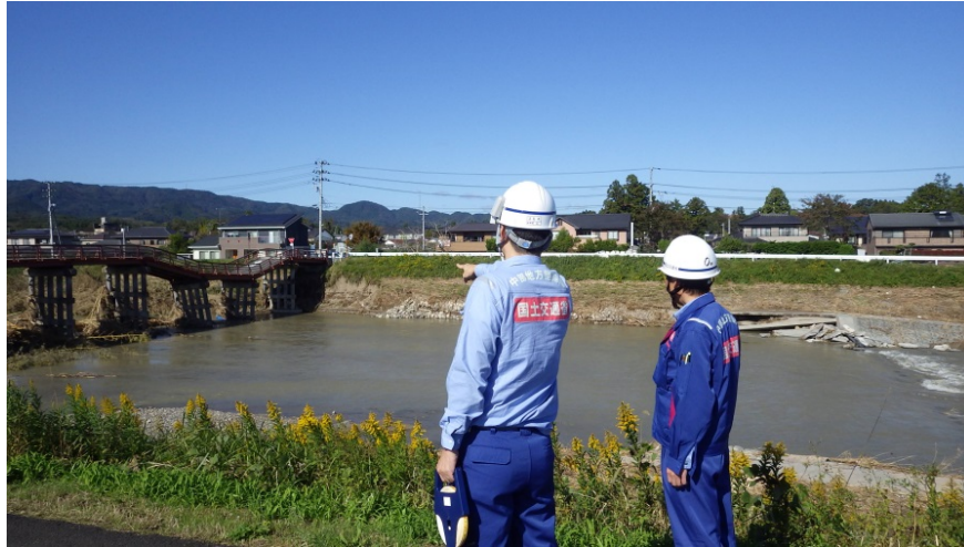
福島県相馬市 宇多川中橋 被災状況調査(河川調査班)
