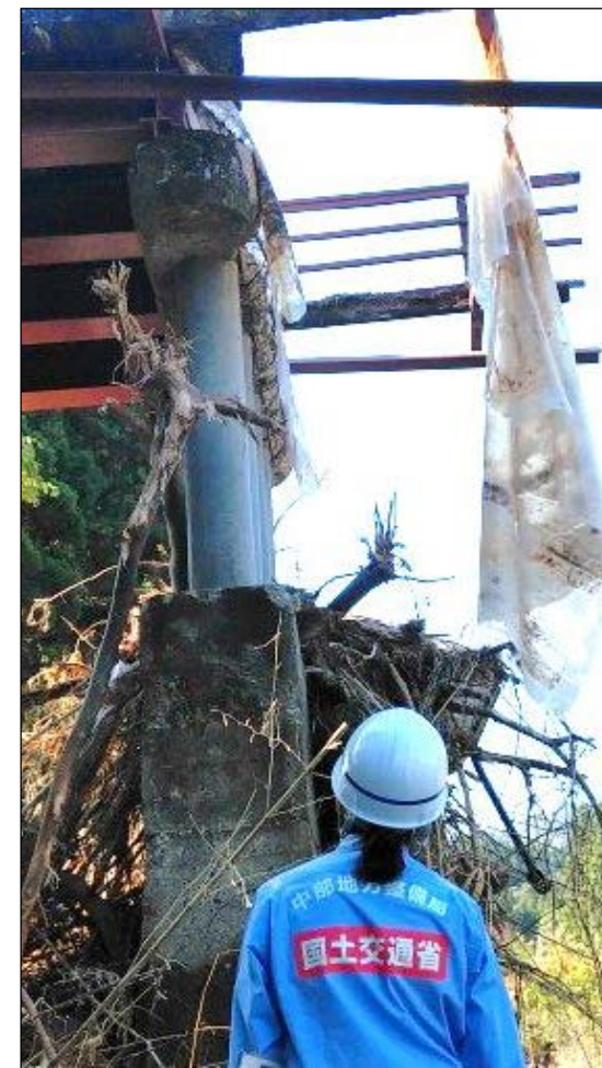
福島県相馬市山上遠藤地先 橋梁崩落状況調査（河川調査班）
