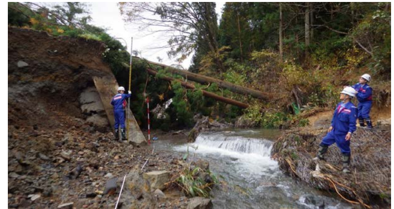
宮城県伊具郡丸森町 聖川 被災状況調査(河川調査班)
