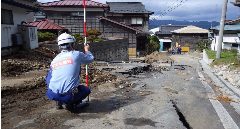
岩手県下閉伊郡山田町船越地内 被害状況調査
