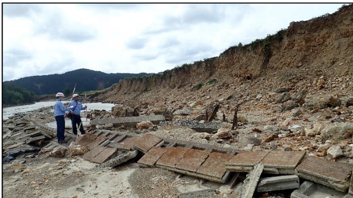
町野川の法面が崩落
