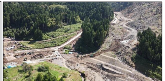
河原田川(市ノ瀬地区)河道閉塞箇所
