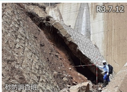
砂防施設の被災状況調査
