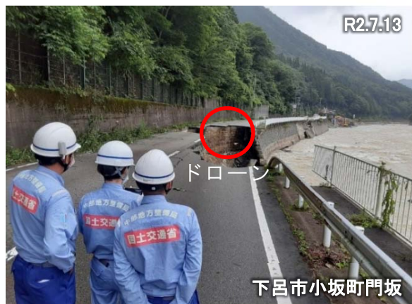
ドローンによる被災状況確認
