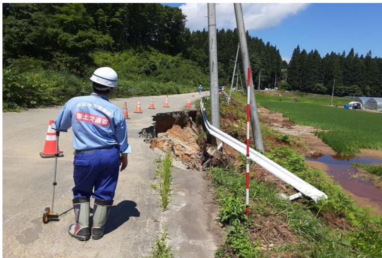
【被災状況調査（路面崩壊）】
