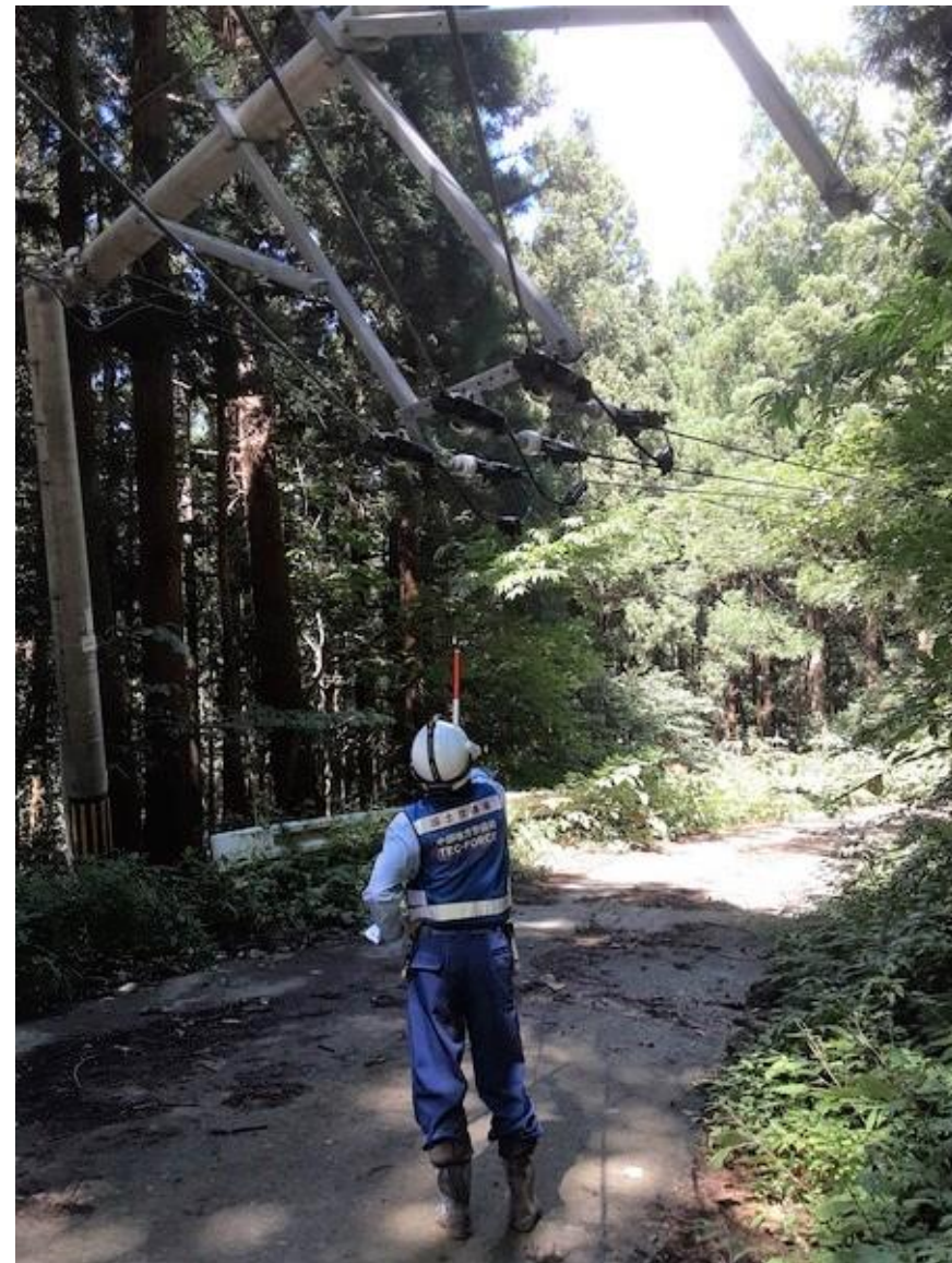
〔道路班 被災状況調査（秋田県由利本荘市）〕
