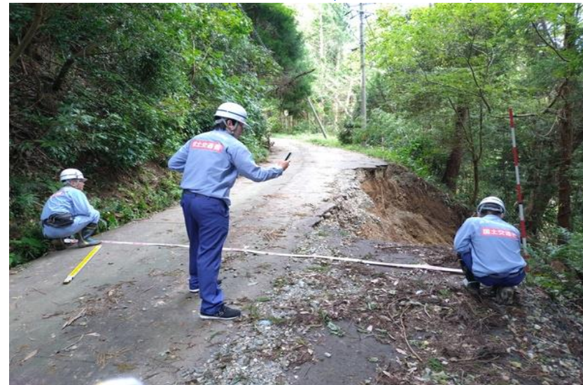
【砂防班 被災状況調査(輪島市門前町)】
