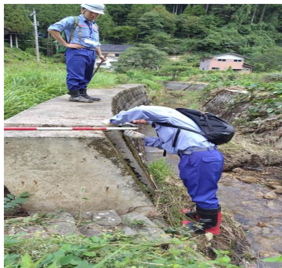
【河川班 被災状況調査(輪島市三井町)】
