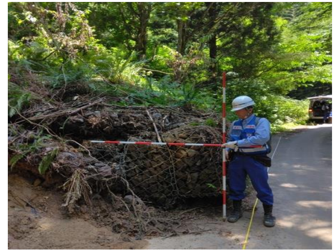
【道路班 被災状況調査（秋田県由利本荘市）】
