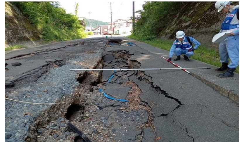
【道路班 被災状況調査（秋田県由利本荘市）】
