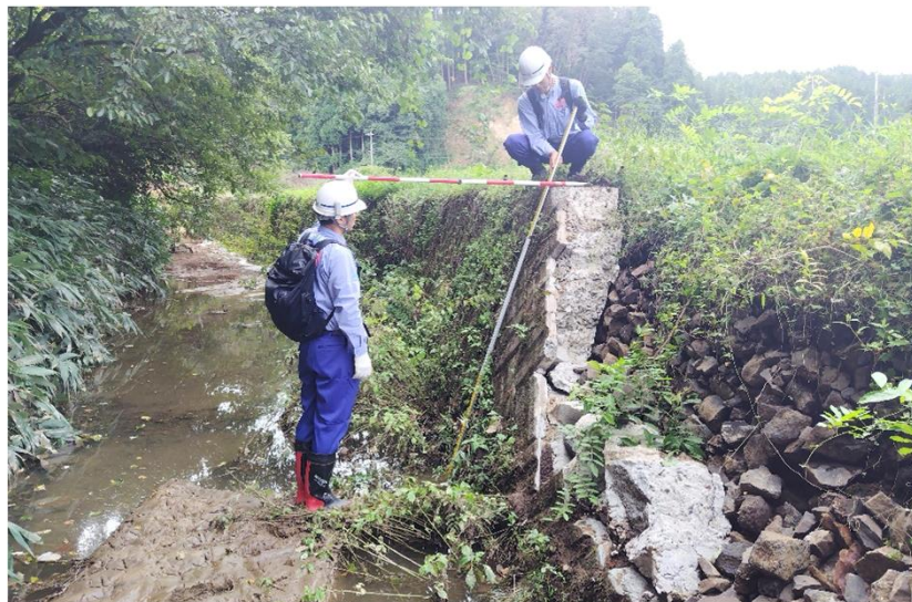
【河川班 被災状況調査(輪島市三井町)】
