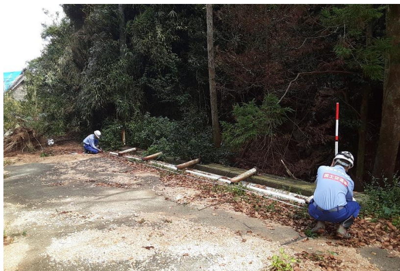
【道路班 被災状況調査(輪島市名舟町)】
