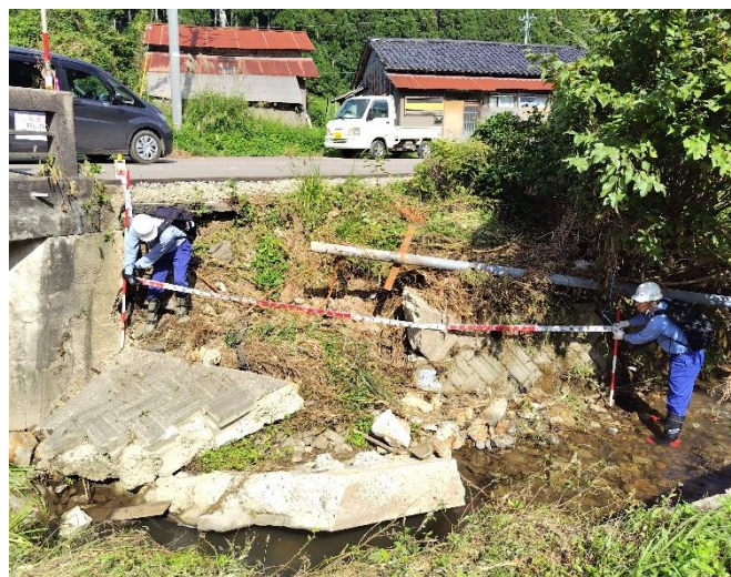
【道路班 被災状況調査(輪島市門前町)】
