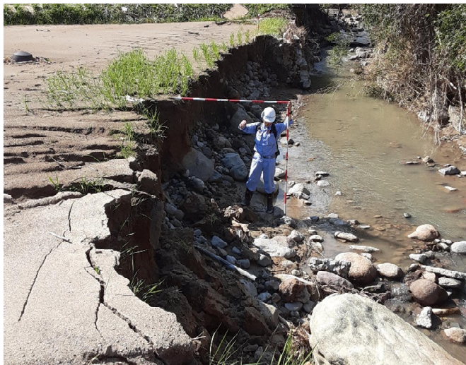
【河川班 被災状況調査(輪島市下黒川町)】
