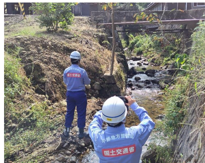
【道路班 被災状況調査(輪島市門前町)】
