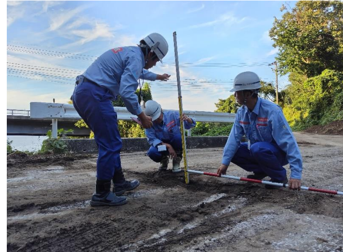
【道路班 被災状況調査(石川県輪島市)】
