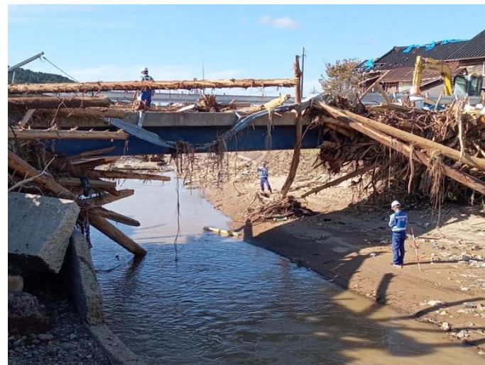
【道路班 被災状況調査(石川県輪島市)】
