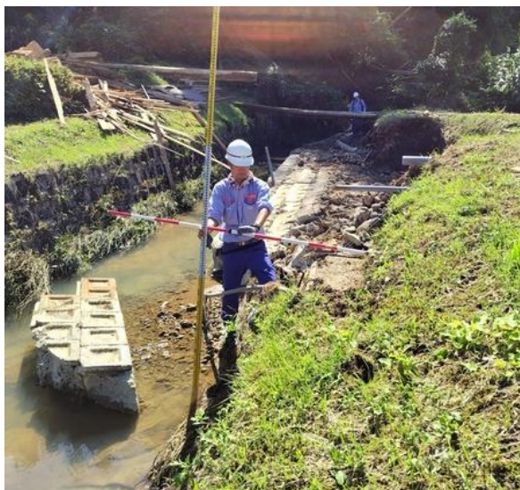
【河川班 被災状況調査(石川県輪島市)】
