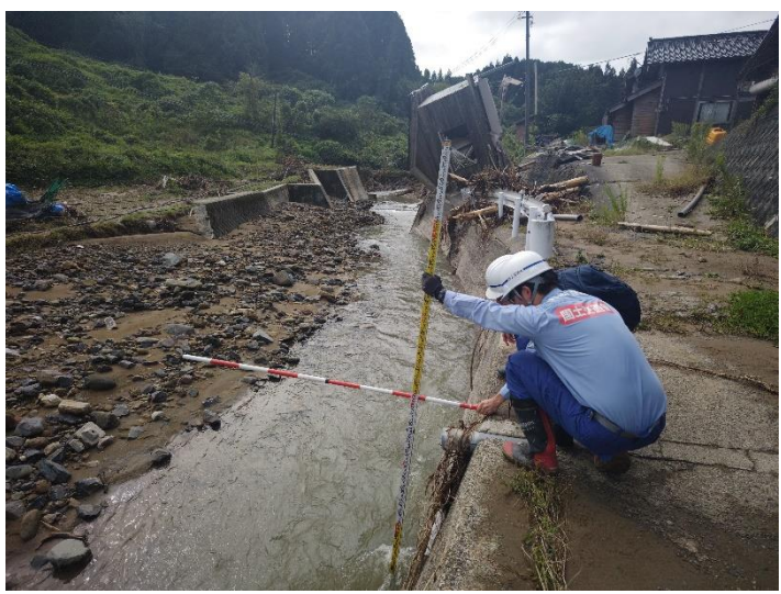
【河川班 被災状況調査(輪島市縄又町)】
