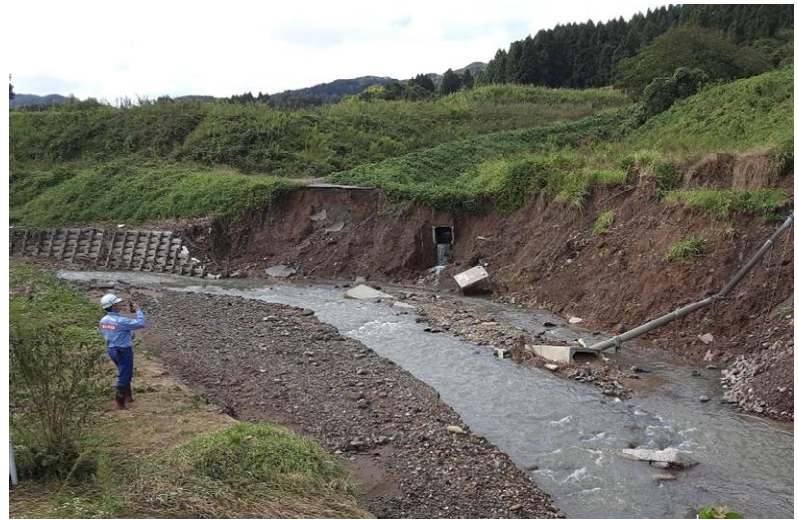
【河川班 被災状況調査(輪島市縄又町)】
