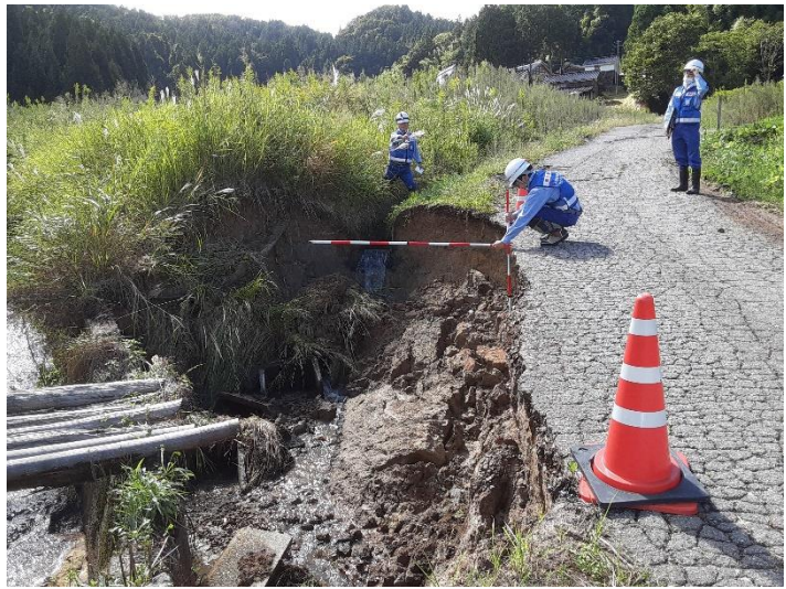
【道路班 被災状況調査(輪島市門前町)】
