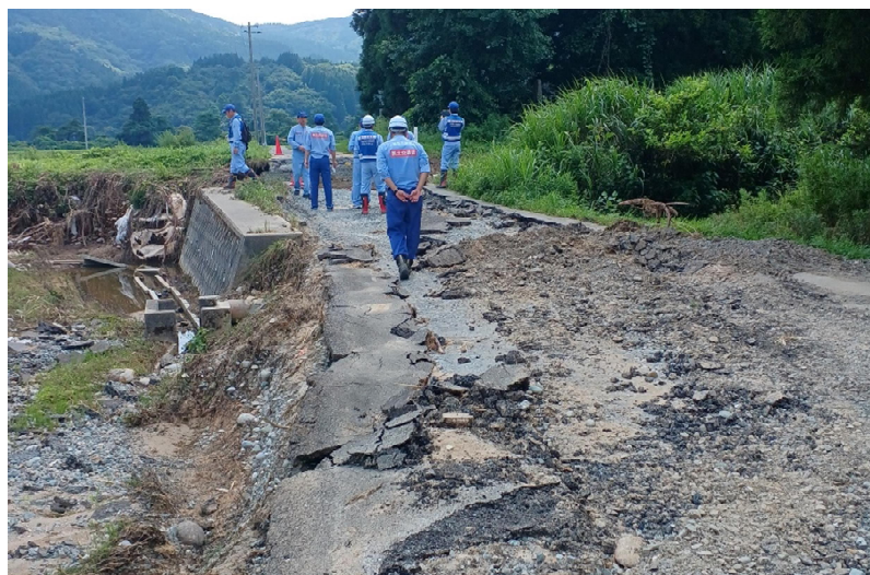
【被災状況調査（山形県庄内町）】
