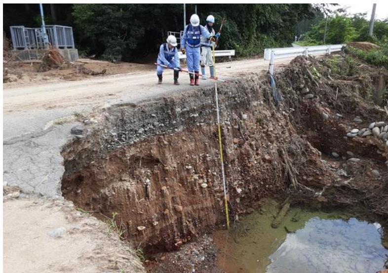
【砂防班 被災状況調査（山形県庄内町）】
