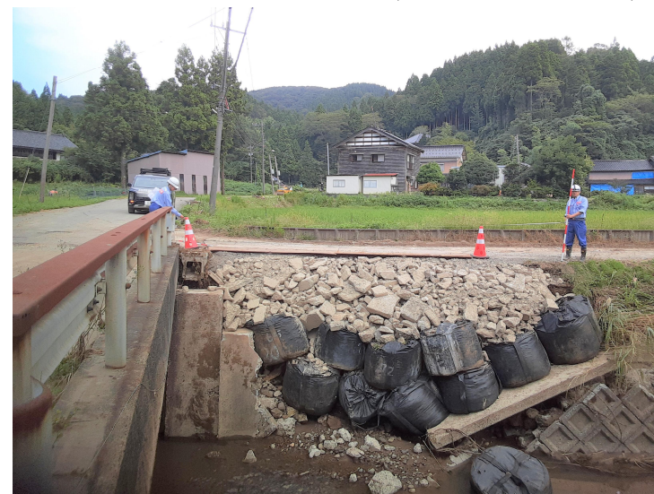
【道路班 被災状況調査（輪島市門前町）】
