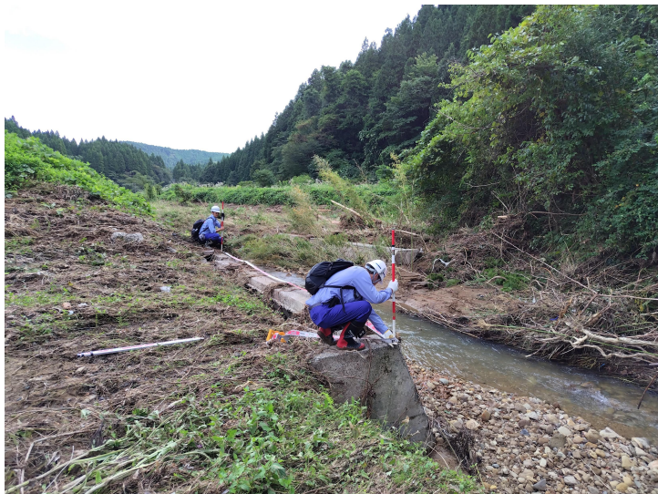
【河川班 被災状況調査(輪島市空熊町)】
