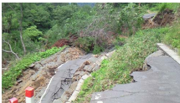
危険溪流調査に向かう途中の道路被災状況（6/16）
