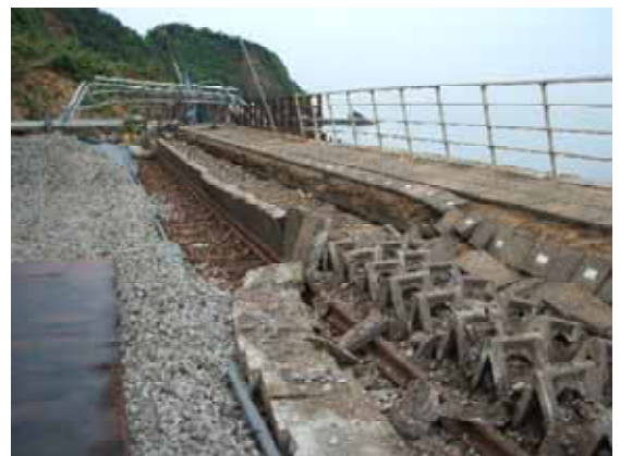
青海川駅被災状況
