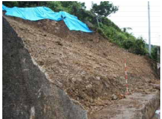
土砂崩落現場
