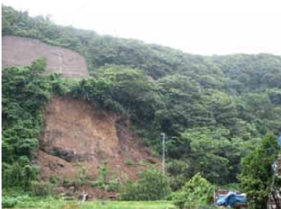
青海川駅アクセス道路 土砂崩落全景
