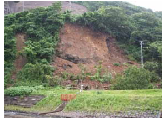
青海川駅アクセス道路 土砂崩落
