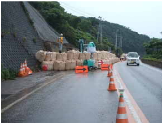
土砂崩落現場
