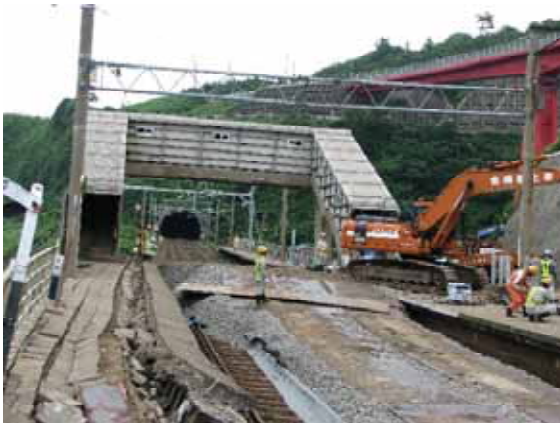
青海川駅被災状況
