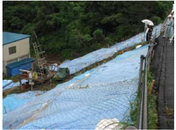
沈下のり面状況
