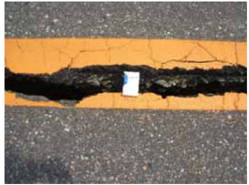
柏崎市椎谷 道路亀裂箇所
