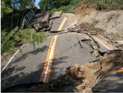
R 8 大積町千本町崩落箇所
