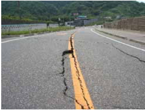
柏崎市椎谷 道路亀裂箇所
