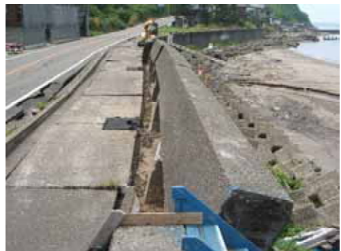
柏崎市椎谷 海岸堤被災箇所
