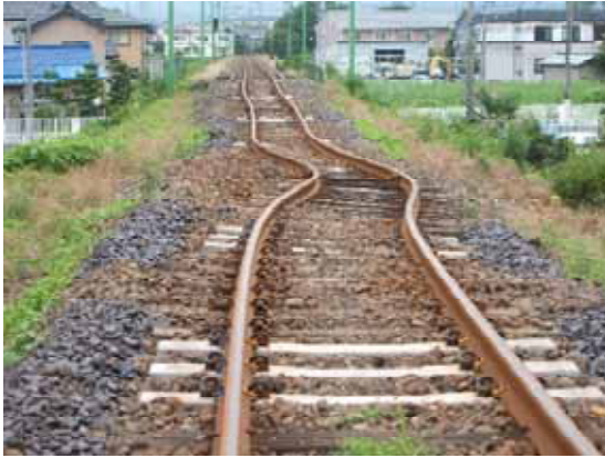
越後線柏崎駅手前被災箇所
