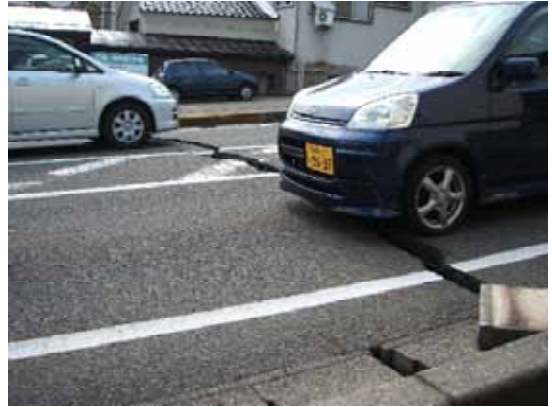
道路クラック箇所通行中
