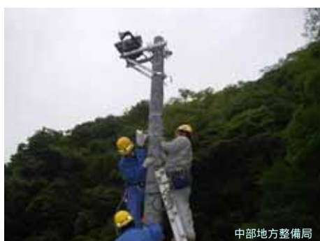
CCTV 配置状況
